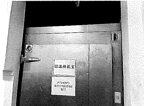
保溫烘乾室外面的電線盒無蓋
